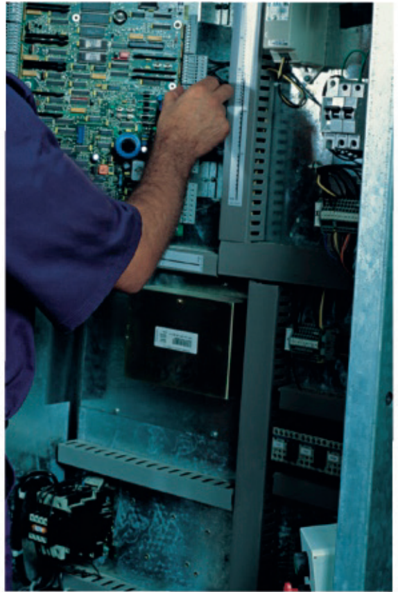
Quadro de Comando de Elevador das oficinas da Atlas Schindler
