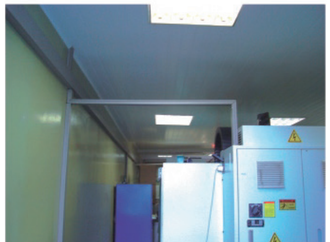
Instalações das Máquinas de erosão a fio. As canaletas são utilizadas como eletrocalhas.
